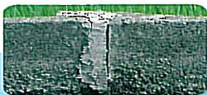
目地(つぎ目)の損傷
