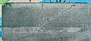
ひび割れ(斜め方向)
