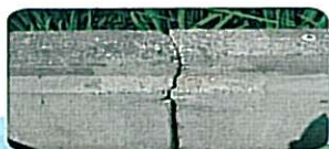
ひび割れ(縦方向)
